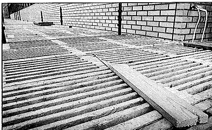
DLI har fått ett fräschare yttre, vilket förhoppningsvis ska innebära ett slut på vattenläckaget (foto: Conny Nylén).
